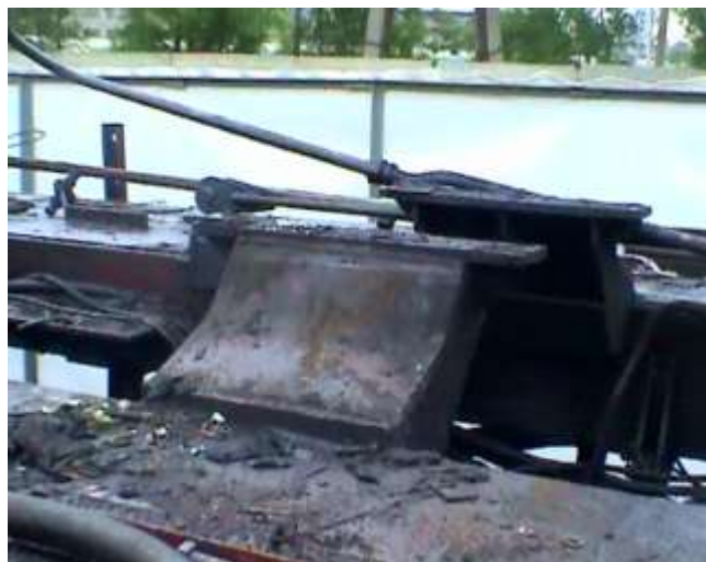
Рис.6. Узел технологического оборудования до очистки
