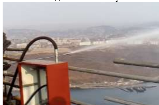
Рисунок 5. Шкаф для подключения рабочих рукавных линий на верхнем открытом этаже подмостей самоподъемной опалубки и подача воды на отметке 300 метров
