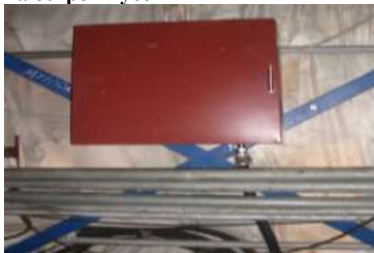
Рисунок 4. Шкаф для подключения рабочих рукавных линий на этажах подмостей внутри самоподъемной опалубки
